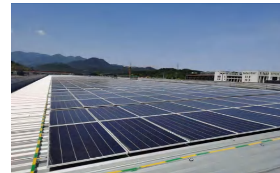
浙江-台州 容量: 1.9MW
