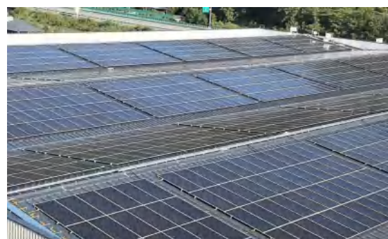
贵州-安顺 容量: 2.9MW
